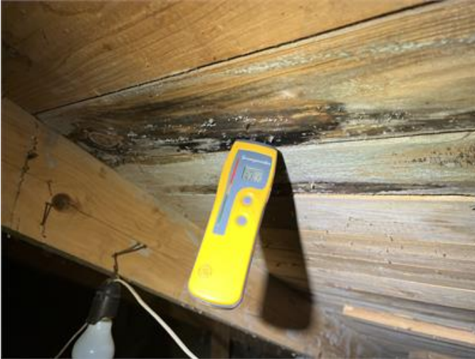
Förhöjda fuktvärden uppmättes lokalt på vinden.
